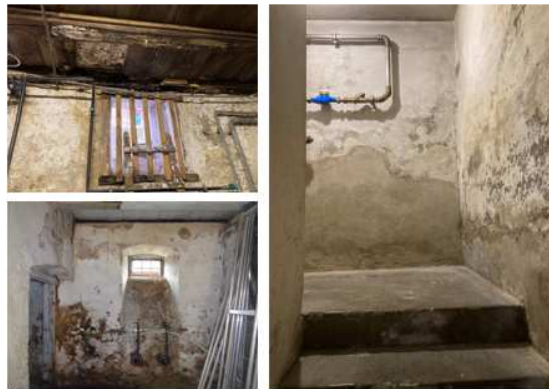
Feuchtigkeit und Salze sind die typischen Schadensbilder in Kellern.
